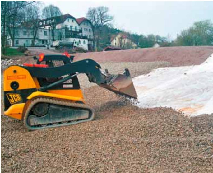
Auf das Vlies wird eine 30 cm dicke Kiesschicht in der Körnung 16/32 mit dem Kompaktraupenlader eingebracht.
