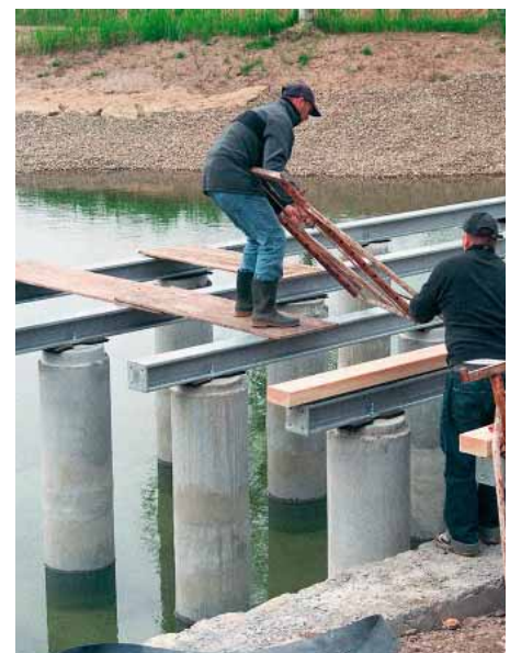
Die Stützkonstruktion wird mit Stahlträgern verbunden, worauf Kanthölzer zur Aufnahme der Douglasi-paneele montiert werden.
