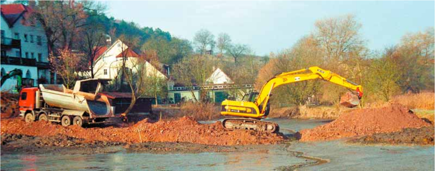
Weil nicht die gesamte Weiherfläche zur Verfügung steht, wird ein Damm geschüttet, dessen Fuß ca. 50 cm ausgehoben wird, damit er nicht unterspült werden kann.
